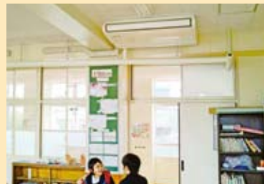
山下小学校の教室に設置が完了したクーラー
